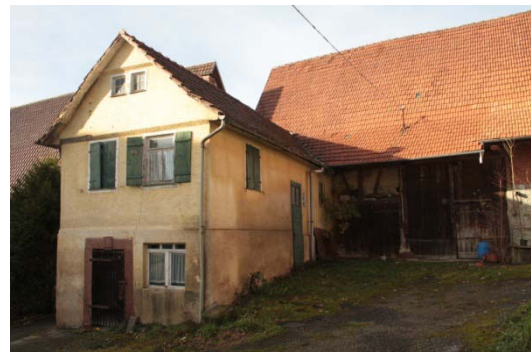
Schillerstraße 12, 8/1: Substanzielle Mängel an der Bausubstanz
